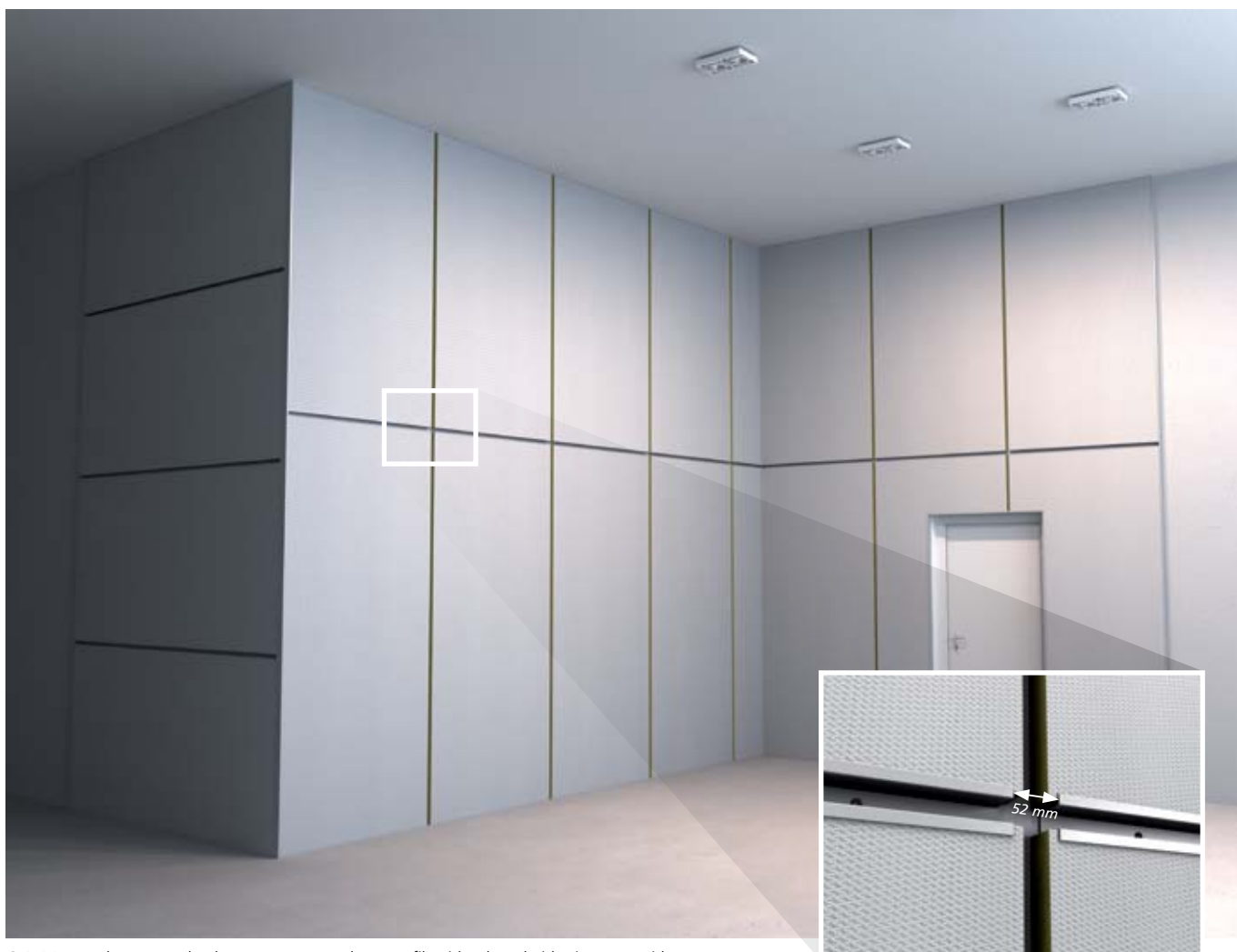
6.4 Monter de resterende plater og vannrette hatteprofiler, idet det arbeides inn mot midten.
